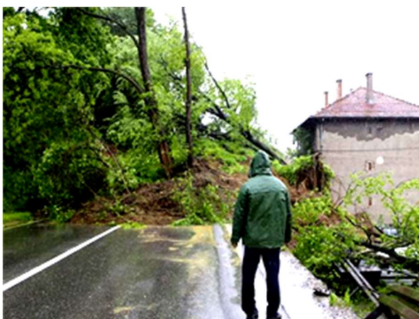
Klizište, Lokacija: Nemila, Main road M17, Topcic polje -Lasva km 3+880 (Poplave 2014)
